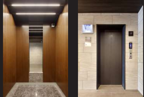
エレベーター
